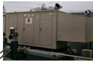
非常用発電機
